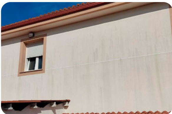
Fig. 3: Moho en fachadas SATE
