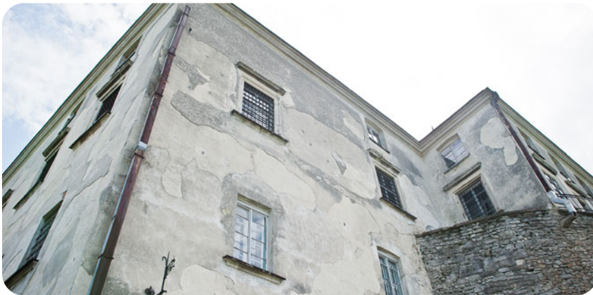
Fig. 1: Fachada en mal estado
