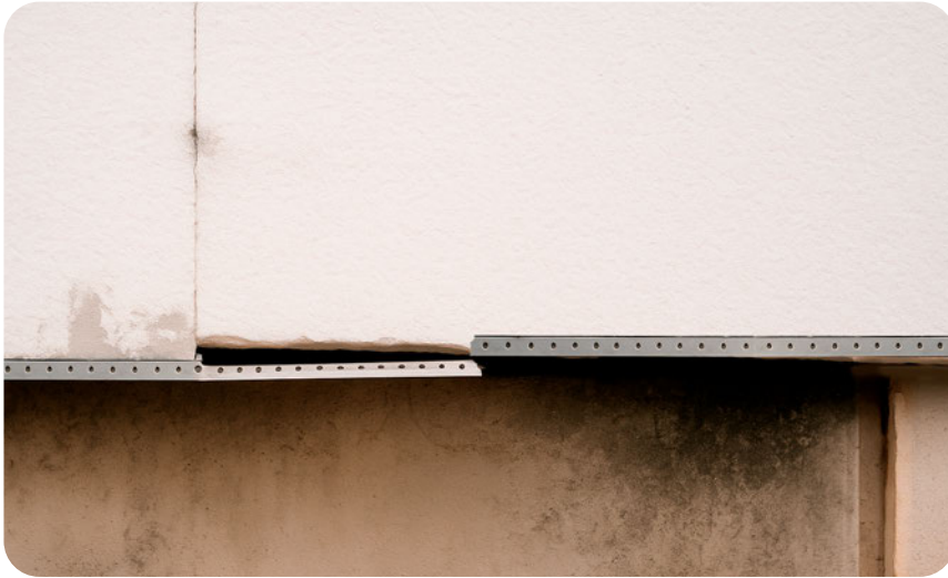
Fig. 16: Instalación incorrecta del perfil de arranque.
