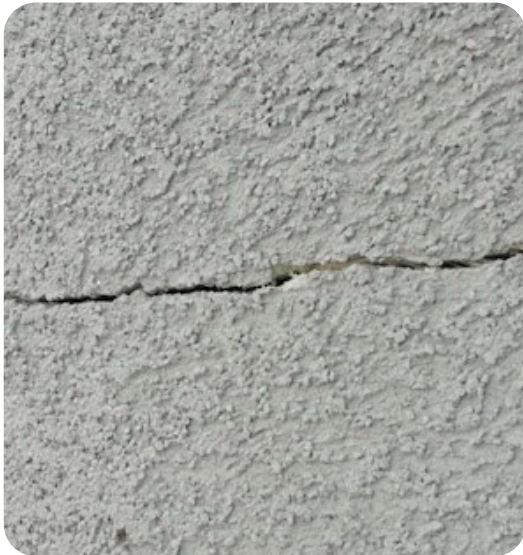
Fig. 11: Grieta en SATE
