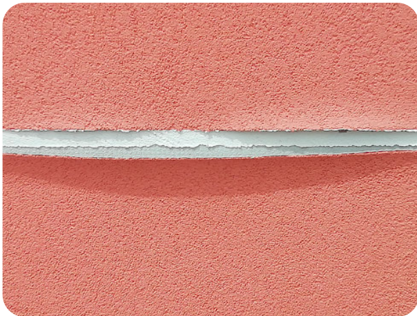
Fig. 28: Falta de adherencia del revestimiento en la junta
