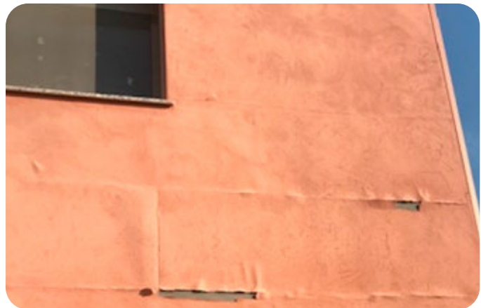
Fig. 18: Fotografía de la patología en fachada.
