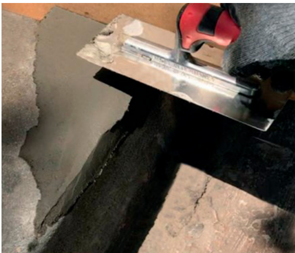
Fig. 3: Fotografía de un parcheo en la esquina de una solera de hormigón
