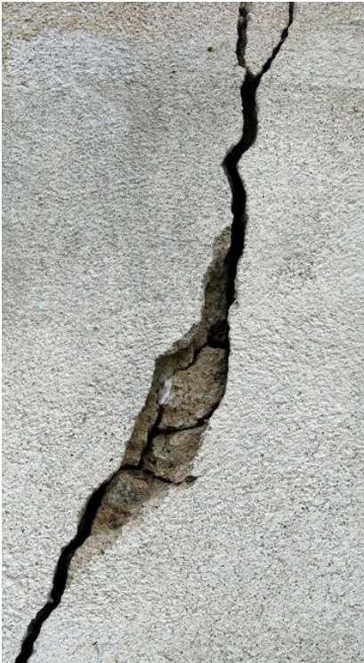
Fig. 5: Fotografía de una fisura sobre hormigón
